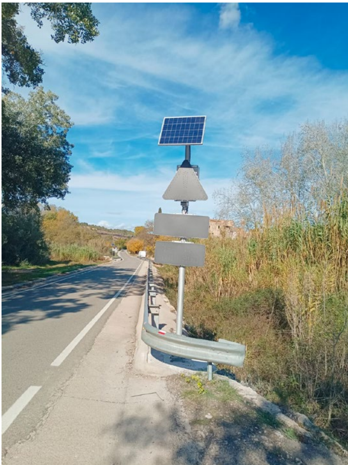
Senyalització vertical del sensor d'inundació.
