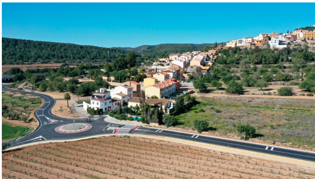
Condicionament de les carreteres TP-2044 i TV-2048, del Vendrell a Sant Vicenç de Calders.
