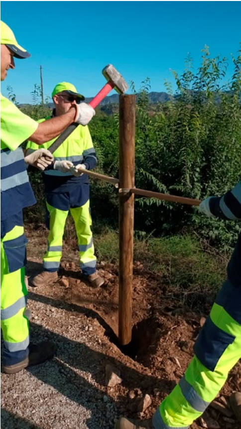
Manteniment de les baranes de fusta de la Via Verda a Roquetes.
