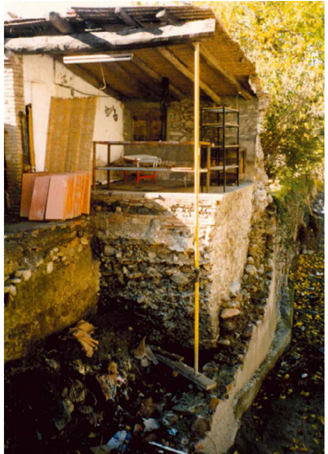
Ensorrament d'una casa després dels aiguats, Porrera, 1994 (AGDT)
