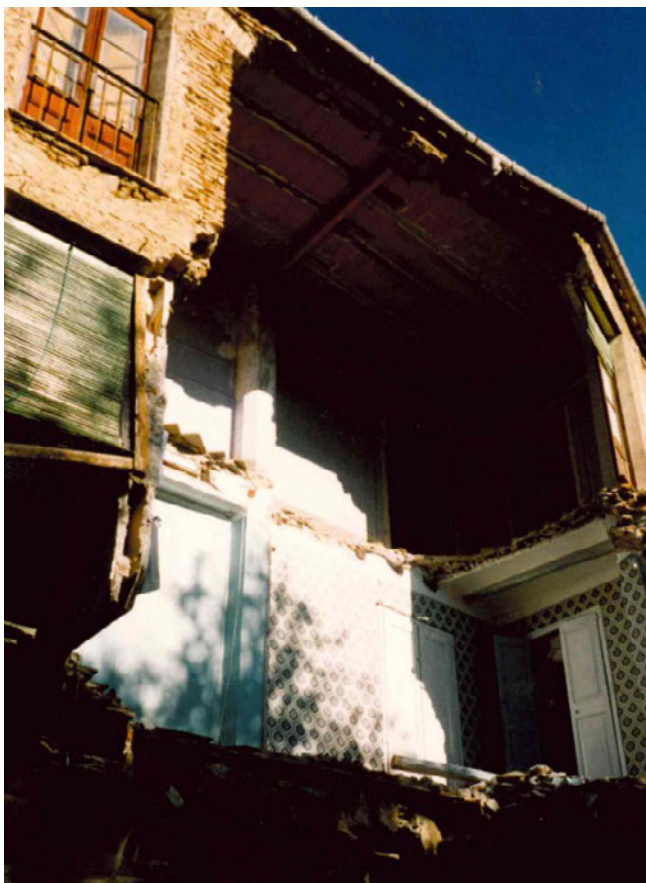
Esfondrament d'una casa Porrera després dels aiguats, Porrera, 1994 (AGDT)
