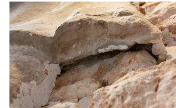
Separació del relleu respecte l'estrat inferior
