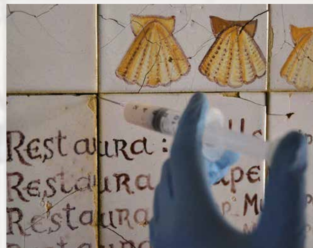
Adhesió al mur de rajoles soltes
