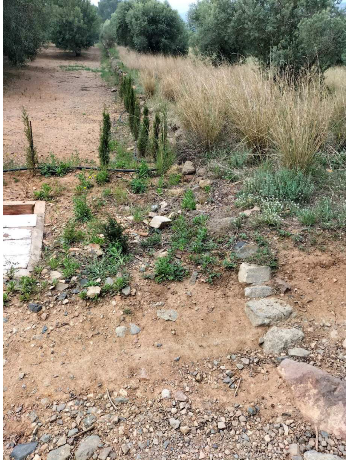
Detall d'antic marge de pedra seca sobrepassat per les aportacions de terra pels treballs agrícoles. S'aprecia que sobrepassa el límit actual del camí.
