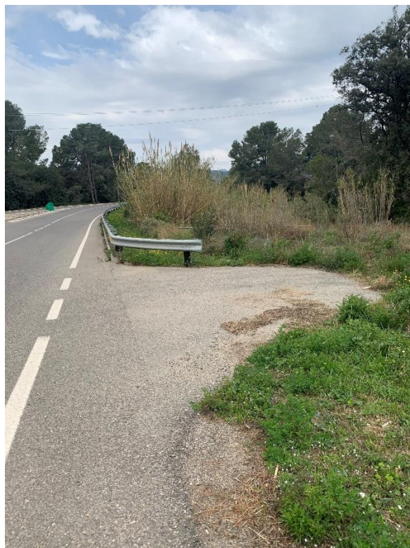
Figura 28. Accés a la vorera dreta del vial i inici de barrera metàl·lica al PK 2+210
