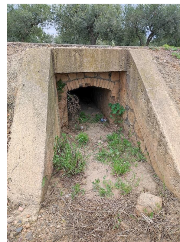
Figura 7. Obra de drenatge transversal que creua la T-310z, al PK 14+000
