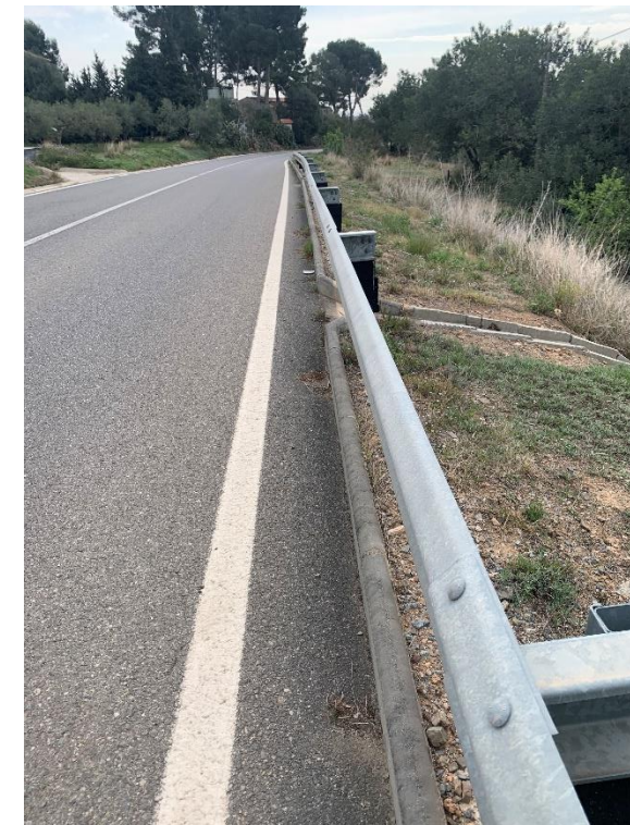
Figura 27. Barrera metàl·lica de seguretat a la vorera dreta al PK 2+100
