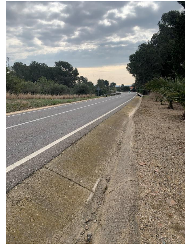
Figura 34. Cuneta de formigó a la vorada esquerra del PK 2+400
