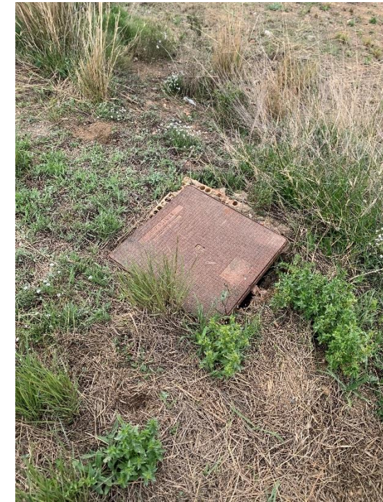
Figura 17. Servei existent núm. 303. Arqueta d'aigua potable, Ajuntament de Vilanova d'Escornalbou. PK 2+089
