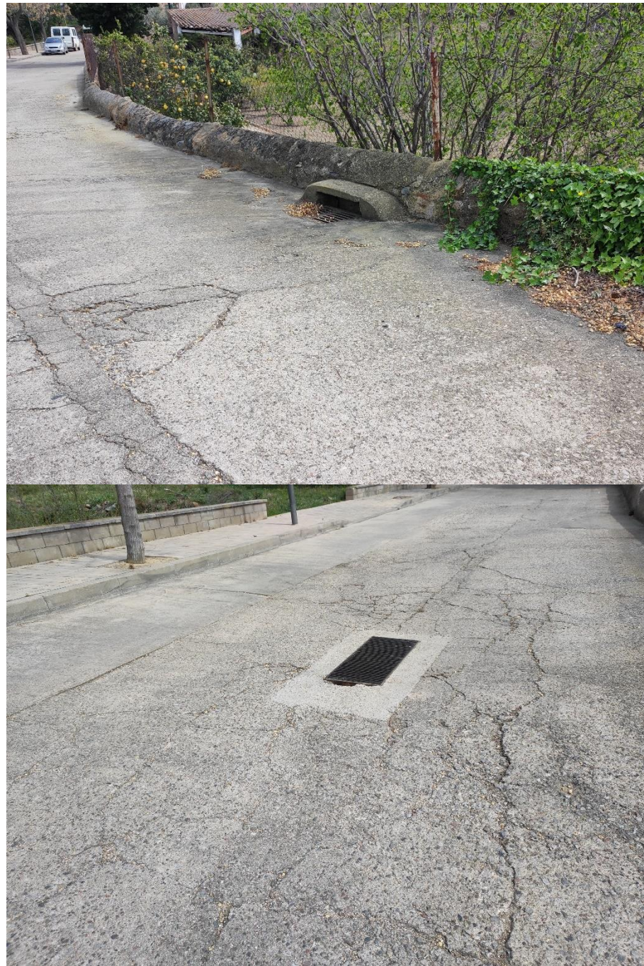
Figura 19. Servei existent núm. 401. Embornals de la xarxa d'aigües residuals, Ajuntament de Vilanova d'Escornalbou. PK 1+327
