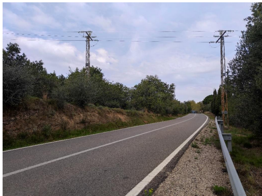
Figura 4. Servei existent núm. 104. Línia aèria MT, Endesa. PK 1+031
