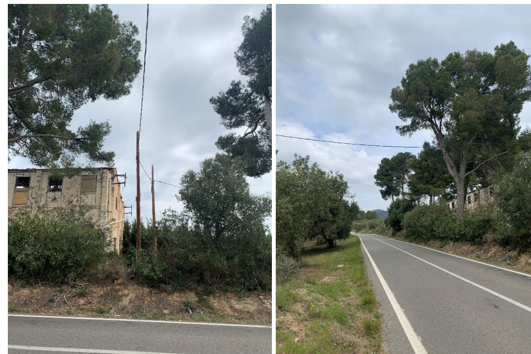
Figura 6. Servei existent núm. 110. Línia aèria BT, Endesa. PK 2+007
