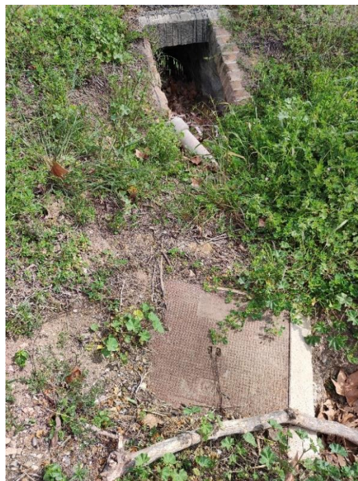
Figura 16. Servei existent núm. 301 i 302. Arqueta d'aigua potable, Ajuntament de Vilanova d'Escornalbou. PK 1+318
