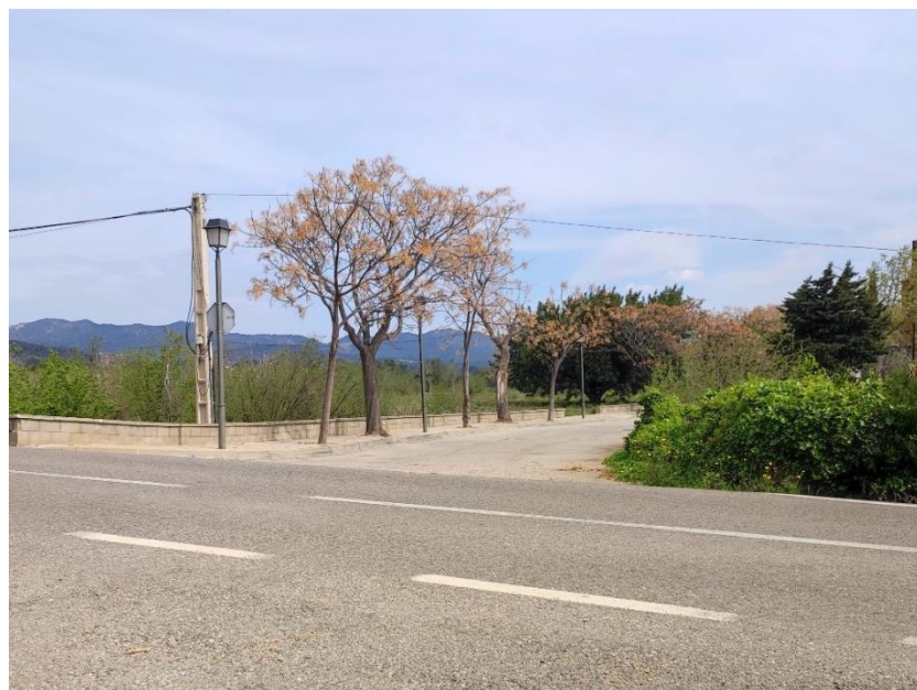
Figura 29. Servei existent núm. 601. Bàculs d'enllumenat, Ajuntament de Vilanova d'Escornalbou. PK 1+331
