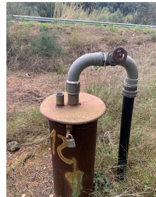
Figura 28. Servei existent núm. 508. Punt d'aigua de la xarxa de reg, Comunitat de Regants de la Mina del Pont. PK 2+324
