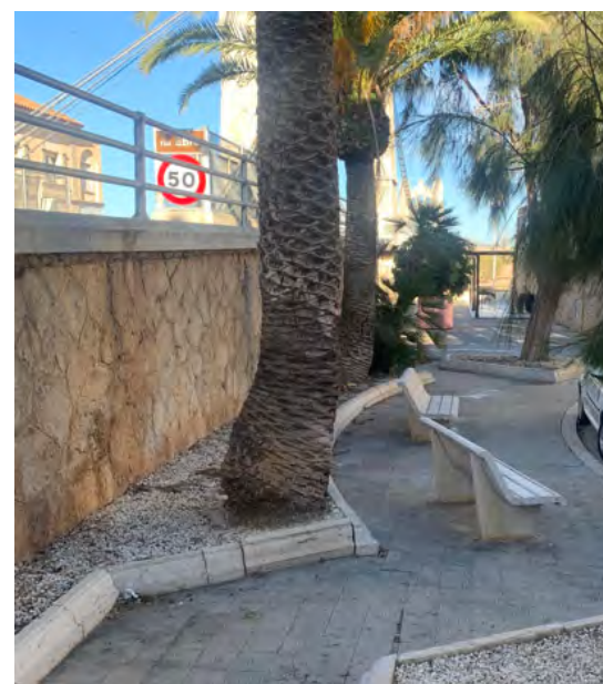
Desnivell rampa sud
