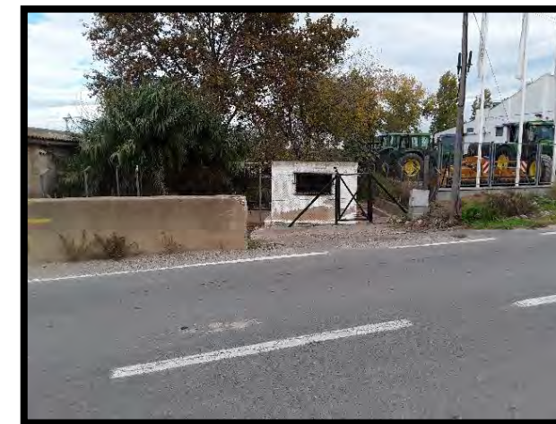
Foto 20. Caseta abandonada a demolir
