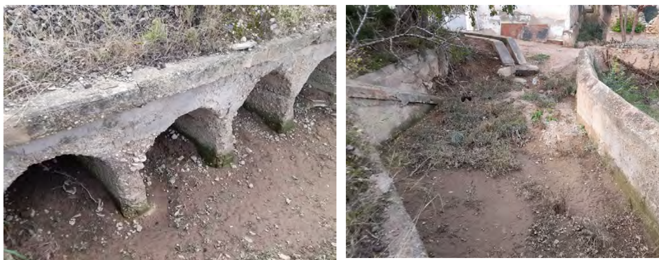
Sistema de drenatge parcialment aterrit
