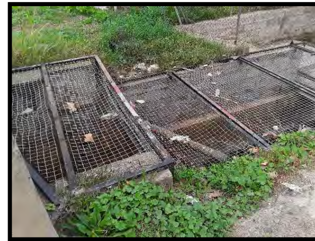
Foto 19. Tramex en mal estat en el tub de desguàs d'aigües pluvials a la sortida d'Amposta
