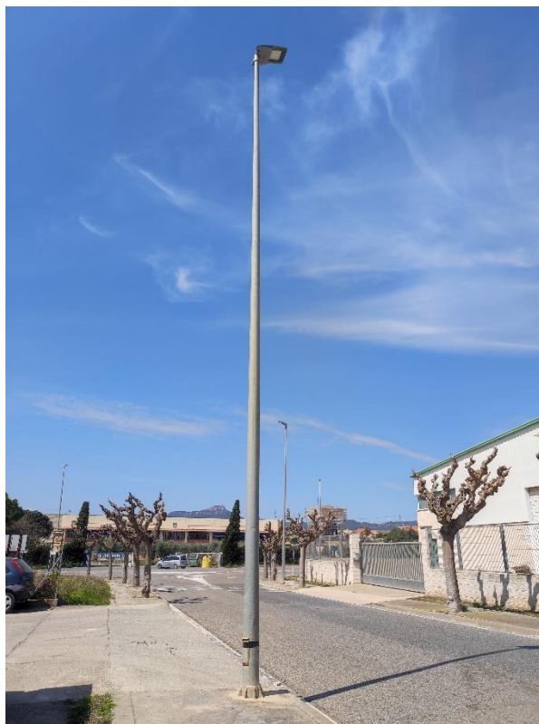
Il·lustració 17. Servei existent 601, bàcul al carrer Verdeguera-Riu Sec
