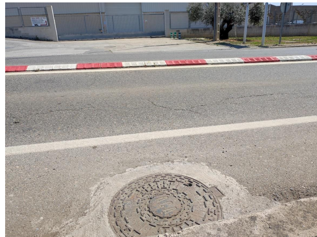
Figura 27. Pou de registre localitzat al final del tram de l'àmbit d'estudi. PK 20+512
