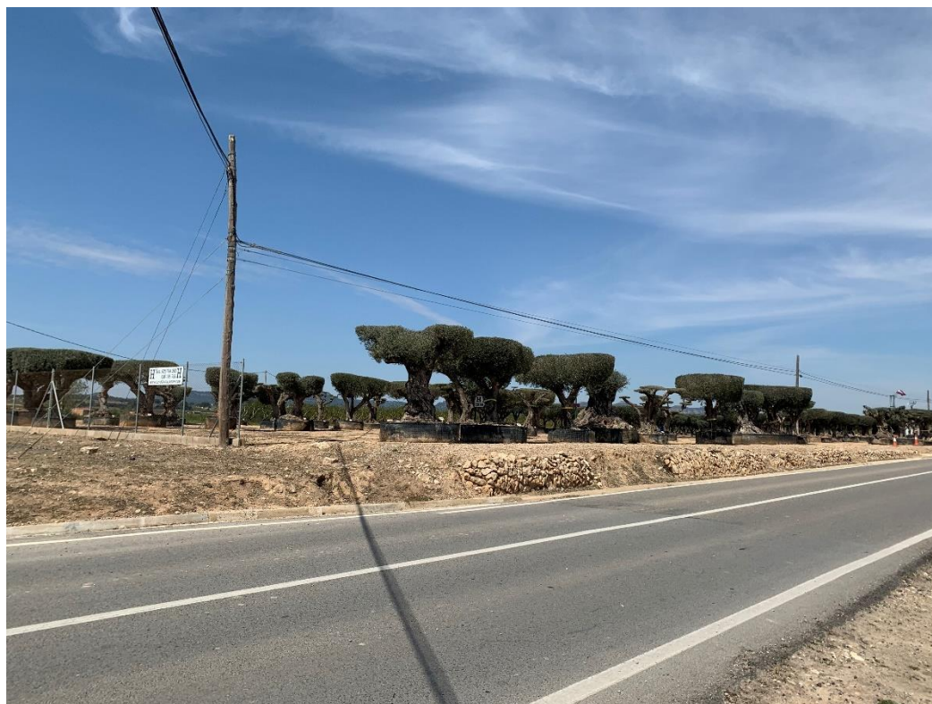
II·lustració 1. Servei existent 201, la línia sobre pals de fusta creua la T-324 abans del PK 18+540
