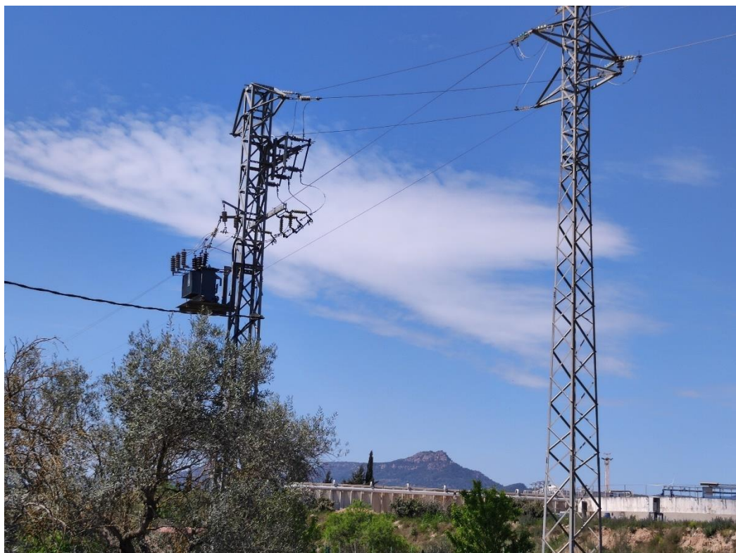
Figura 21. Torres metàl·liques de línia de mitja tensió al marge esquerre al PK 20+320
